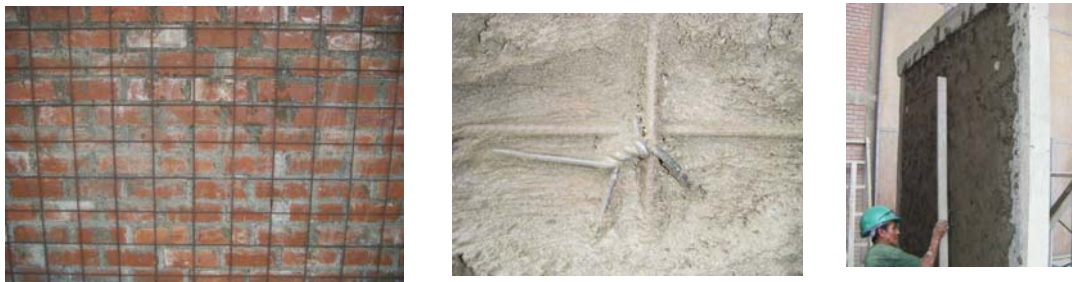
Fig.7. Malla electrosoldada (izquierda), conector (centro) y tarrajeo (derecha).
