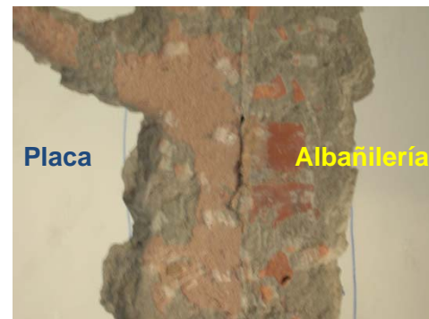
Grieta vertical en la unión placa-albañilería, cortesía del Ing. Oscar Fernández Cruz.
