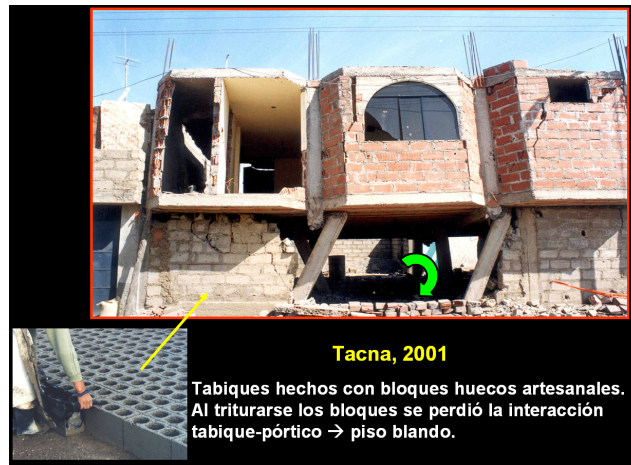
Fig.6 Piso blando causado por la falla de tabiques.
