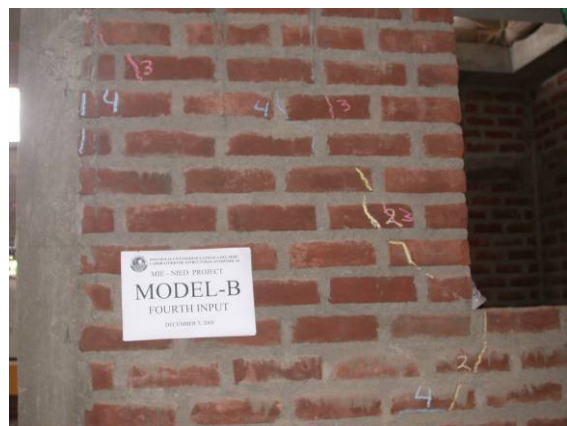
Fig. 9: Muro del Módulo B después del ensayo, con las fisuras marcadas por fase
