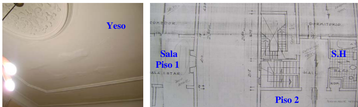
Fig.4. Casa 2. Indicios de corrosión en el techo de la Sala del primer piso.
