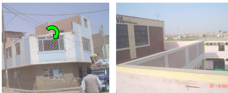
Fig.9.26 Pisco, parapeto sin arriostrar (izq.) y arriostrado en el tercer piso (der.).
