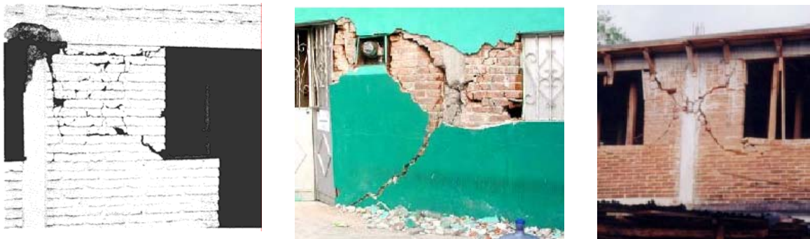
Fig.7.7. Comportamiento sísmico de Muros No Confinados.
