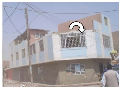
Fig.6.32 Pisco 2007, parapeto sin arriostar (izq.) y arriostrado en el tercer piso (derecha).
