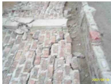
Fig.6.31 Chilca, sismo de Pisco del 2007. Columna sin refuerzo (izq.) y con mochetas (derecha).
