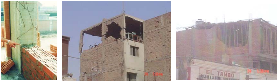
Fig.2.5. Técnica constructiva inadecuada y consecuencias en el sismo de Pisco.
