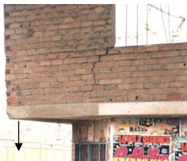
Fig.1.5. Agrietamiento por deflexión de un voladizo.
