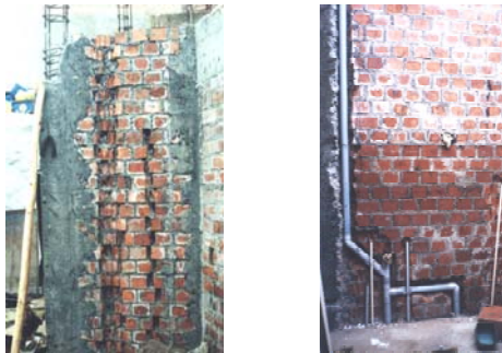
Fig.1.15. Debilitamiento de la conexión columna-albañilería.
