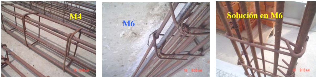
Fig.5. Defectos en los ganchos de los estribos en M4 y M6 y solución en M6.
