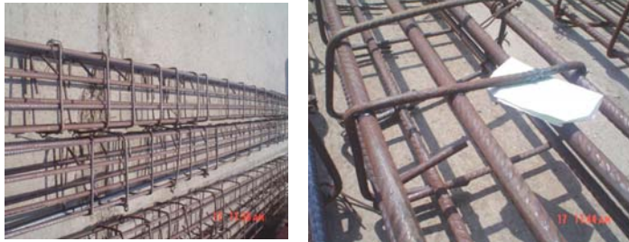
Fig.4 Canastilla de M6 y estribos desoldados.
