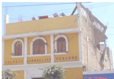
Fig.20 Muros sin diafragma rígido.
