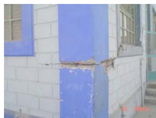
Fig.19. Columna de concreto sin refuerzo.
