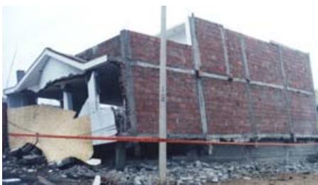
Figura 5. Vivienda colapsada por tener poca densidad de muros en la dirección de la fachada; sismo del 23 de junio del 2001 en el sur del Perú
