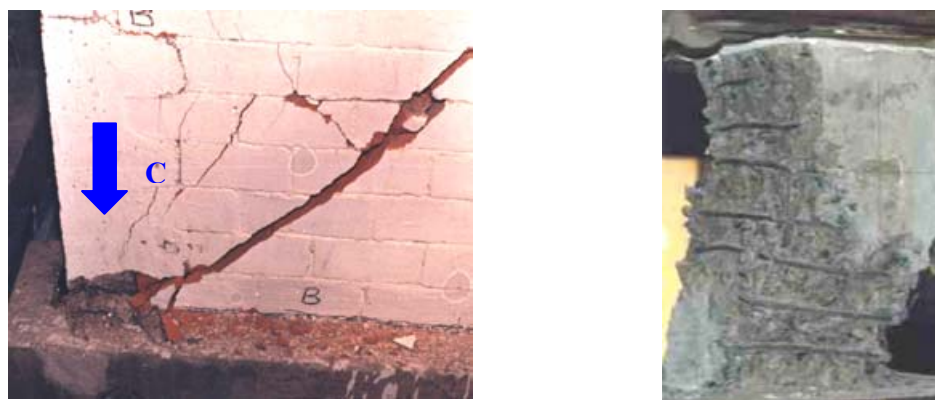
Figura 17. Falla por aplastamiento de una columna (izquierda) y desprendimiento del recubrimiento, manteniendo el núcleo confinado sin daños (derecha)
