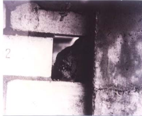
Fig.9. Cangrejera en la Conexión Dentada. Muro de la Ref.3.
