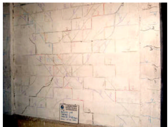
(b) Fisuración en tabiques - Espécimen IM2
