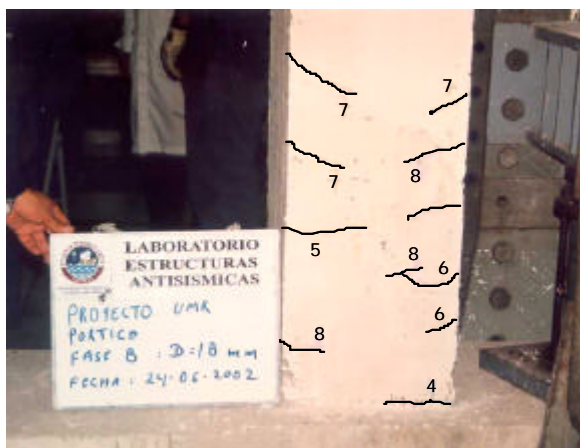
(a) Fisuras en columnas - Espécimen RC-F
