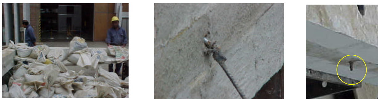
Fig.11. Colapso del tabique (izq.), falla por anclaje del perno expansivo (centro) y falla en el punto de soldadura perno-refuerzo vertical del tabique (der.).
