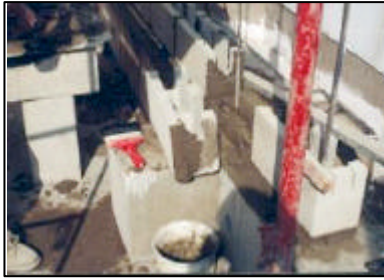
Foto 5. Junta vertical en el muro R3.
