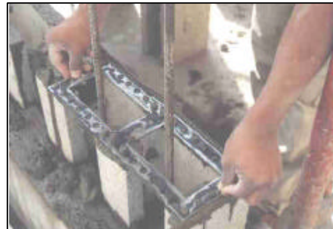
Foto 8. Plancha en los talones del muro R3.
