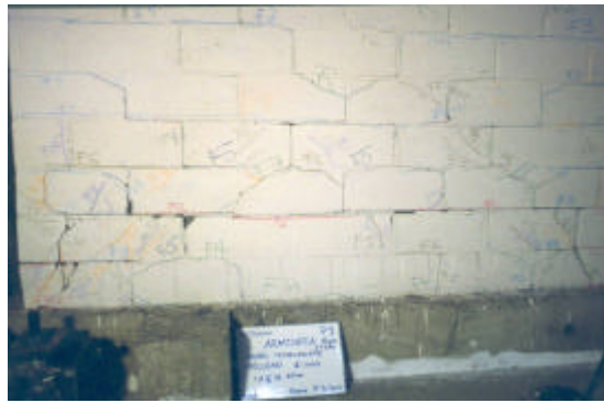
Foto 10. Falla típica por deslizamiento en las primeras hiladas.
