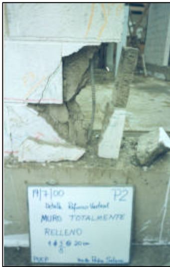
Foto 11. Trituración del talón, nótase el pandeo del refuerzo vertical
