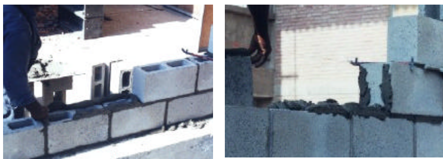
Fig.7 Cintas de mortero en las juntas.
