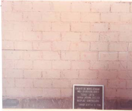
Fig.7. Falla por Traslape en MG1.Fase 9.
