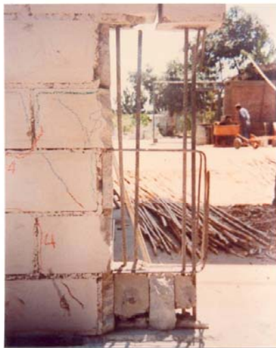
Fig.9. Talón de MG2. Defectos del Traslape y Junta Fría Mortero Fluido-Cimentación.
