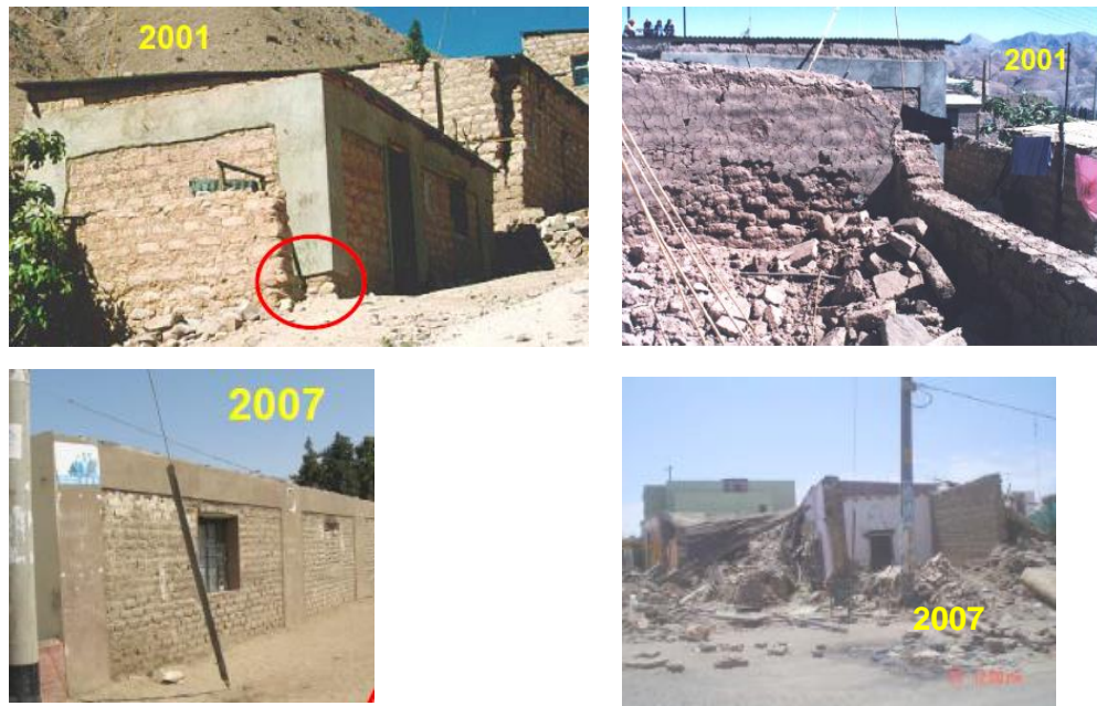
Fig.24. Comportamiento de las viviendas reforzadas con la malla y sin reforzar ante los terremotos del 2001 y 2007.
