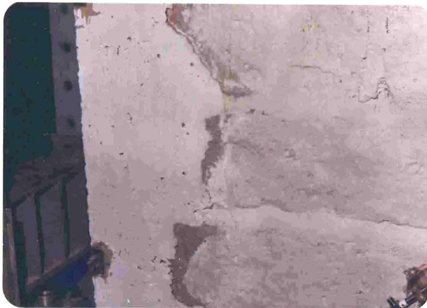
FOTO N° 22 EFLORESCENCIA PERSISTENTE, AUN DESPUES DE HABER APLICADO LA PINTURA DE CAL
