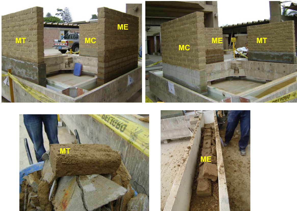
Fig.11. Estado final de los muros MC, ME y MT tras 16 días de inundación y estado de los adobes localizados en la base de MT y ME.
