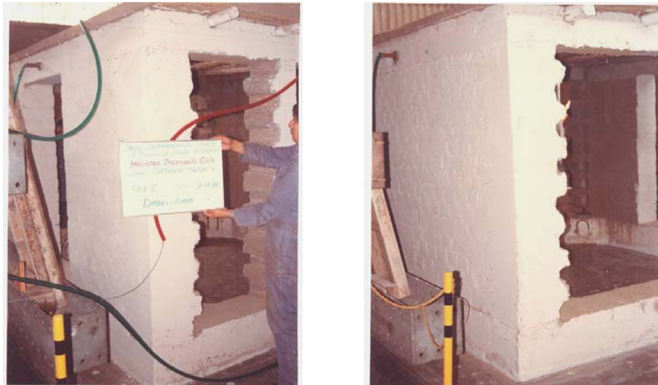
Fig.7. Fase (D = 60mm), correspondiente al ensayo complementario. Fisuras en los extremos del collarín y las columnas, y en la interfase collarín-muro del eje 2.
