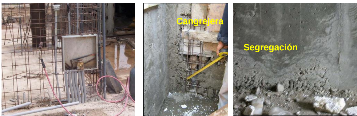
Fig.1. Defectos ocasionados por la congestión de refuerzo y conductos en muros delgados: cangrejera y segregación del concreto.
