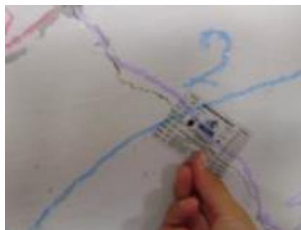
Fig.14. Medición del grosor máximo de grieta ( G ) con el comparador y con wincha.
