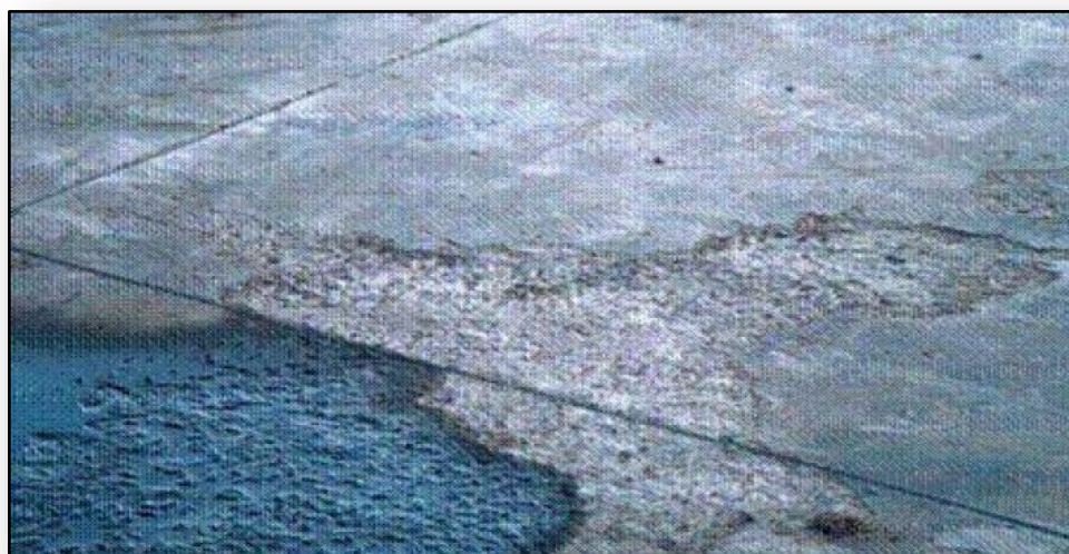
Figura 1.4 – Ataque por congelamiento de una losa
