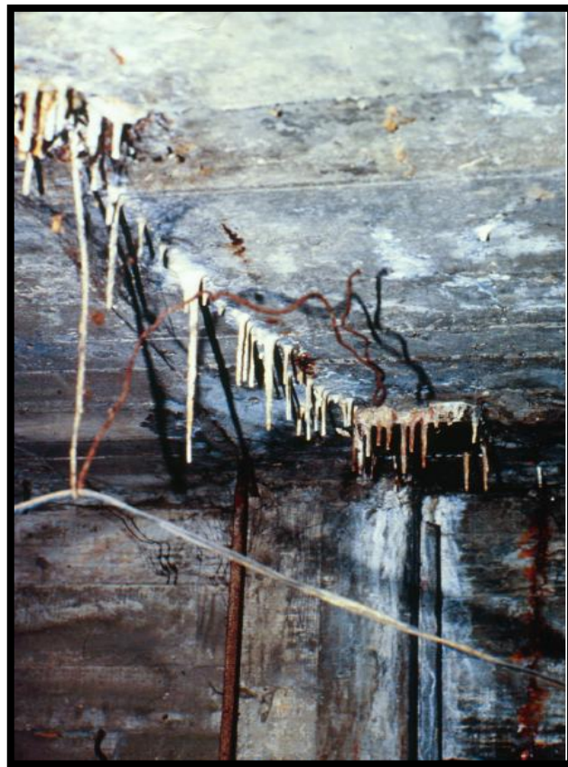
Figura 1.6 Pérdida de sección de acero útil
