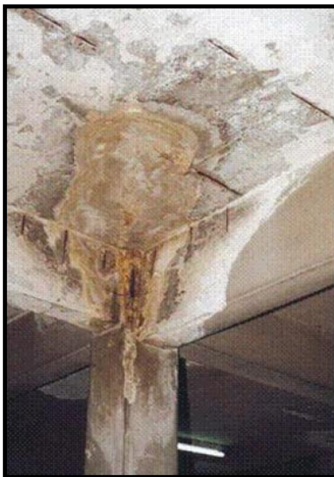
Figura 1.5 Pérdida de sección de acero útil
