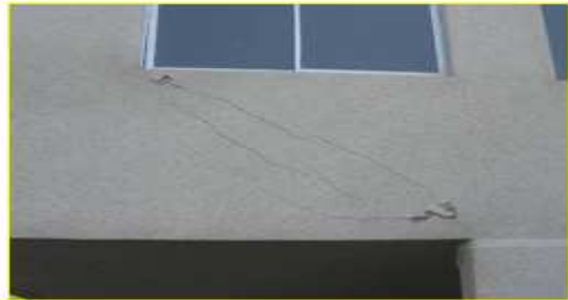
Foto 2 Fisura en viga
