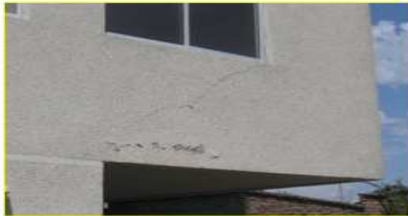
Foto 1 Fisura en viga
