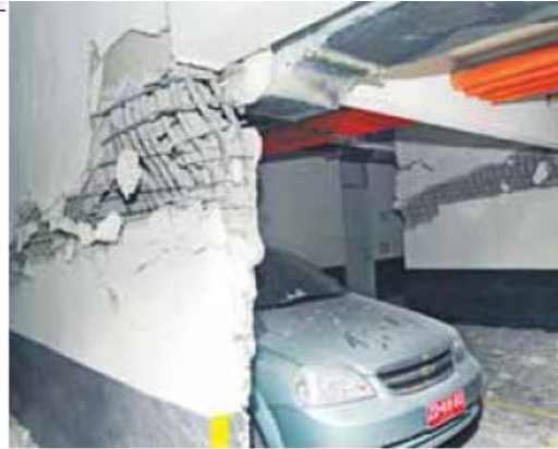
Fallas y grietas eran evidentes en el edificio Emerald, de la empresa Paz en Ñuñoa.
