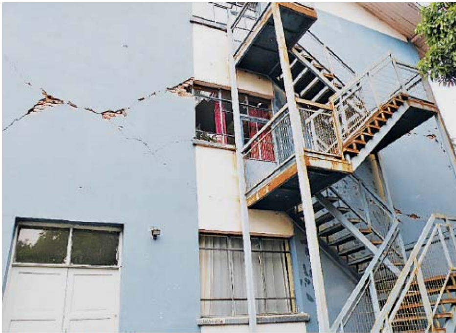
El liceo Pablo Neruda, de La Araucanía, con daños en muros y la caja de escala.
