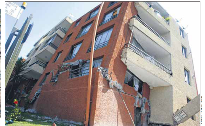
Colapso del condominio "Don Tristán en Maipú" se convirtió en símbolo del terremoto en Santiago.
