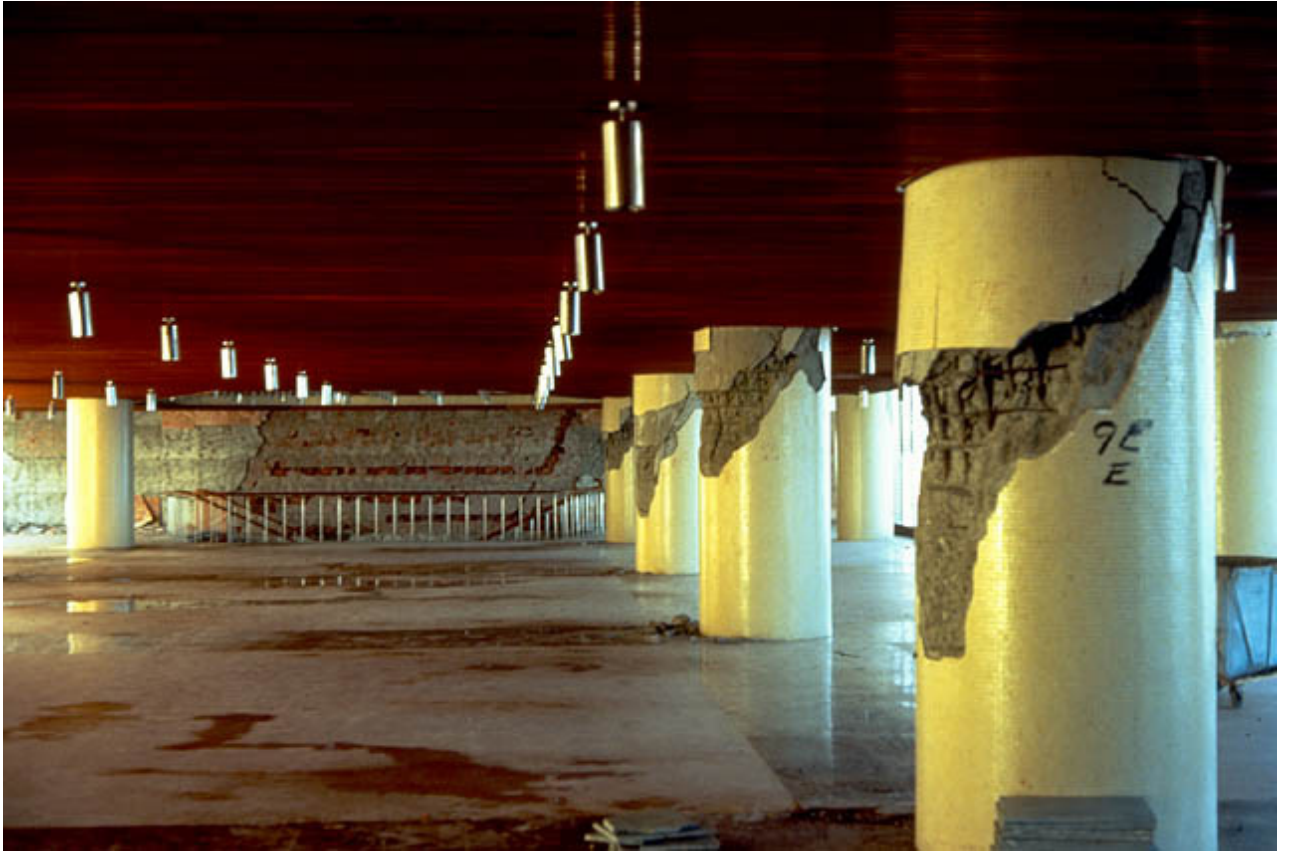
Fig. 3.19 Destrucción de las columnas del 1er piso de un edificio (Caracas, 1967).
