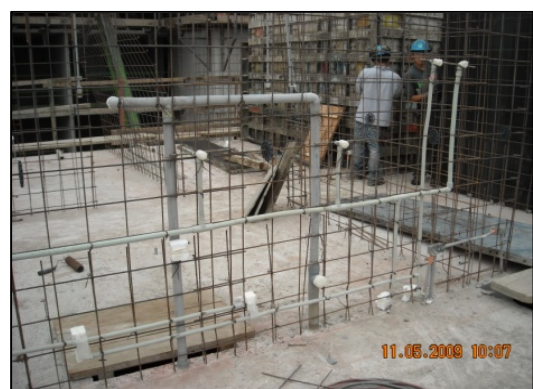
Foto 10.- Tuberías de Agua Fría y Caliente dentro de los MDL
