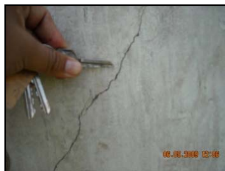
Foto 23.- Espesor máximo de fisura encontrada es de 0.5mm.
