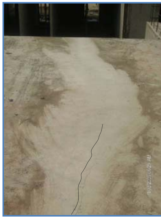
Foto 25.- Fisuras en las zonas luces centrales (sala)
