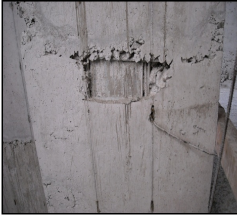
Foto 22.- Cangrejeras en zonas de concentración de tuberías
