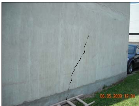
Foto 24.- Fisura en la parte inferior de los MDL de longitud 8m.
