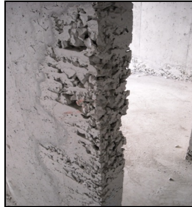
Foto 23.- Segregación de agregado
