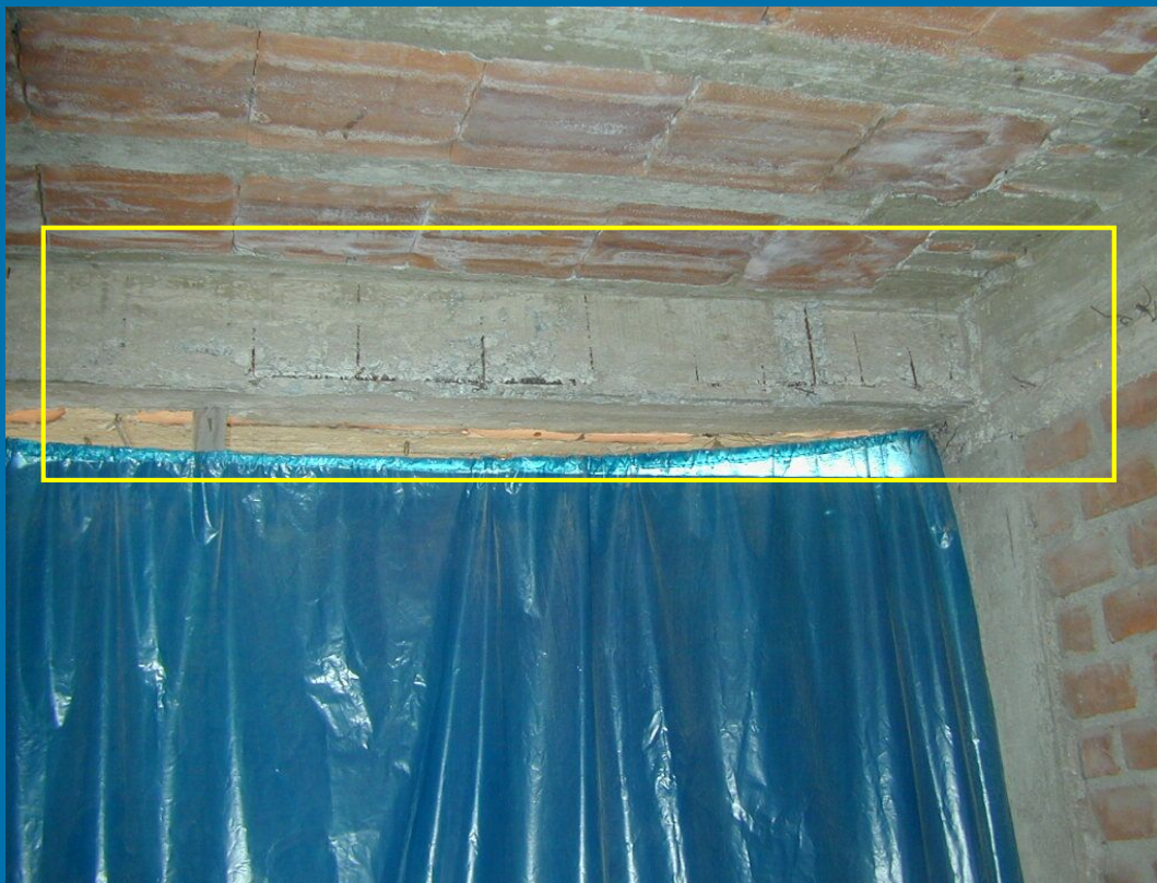
Falta de recubrimiento
