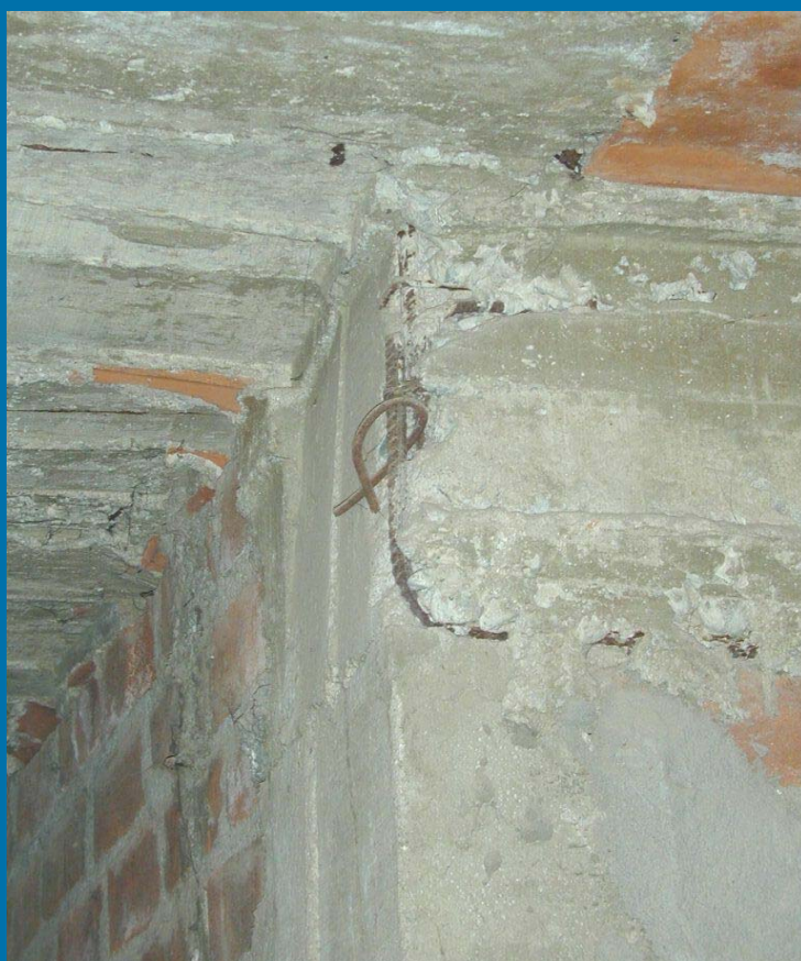
Cangrejas y falta de recubrimiento
