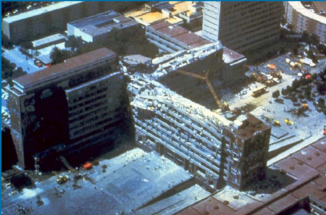
México, 1985. Central de telecomunicaciones
