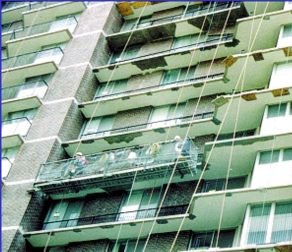
Volados Expuestos a la brisa marina
