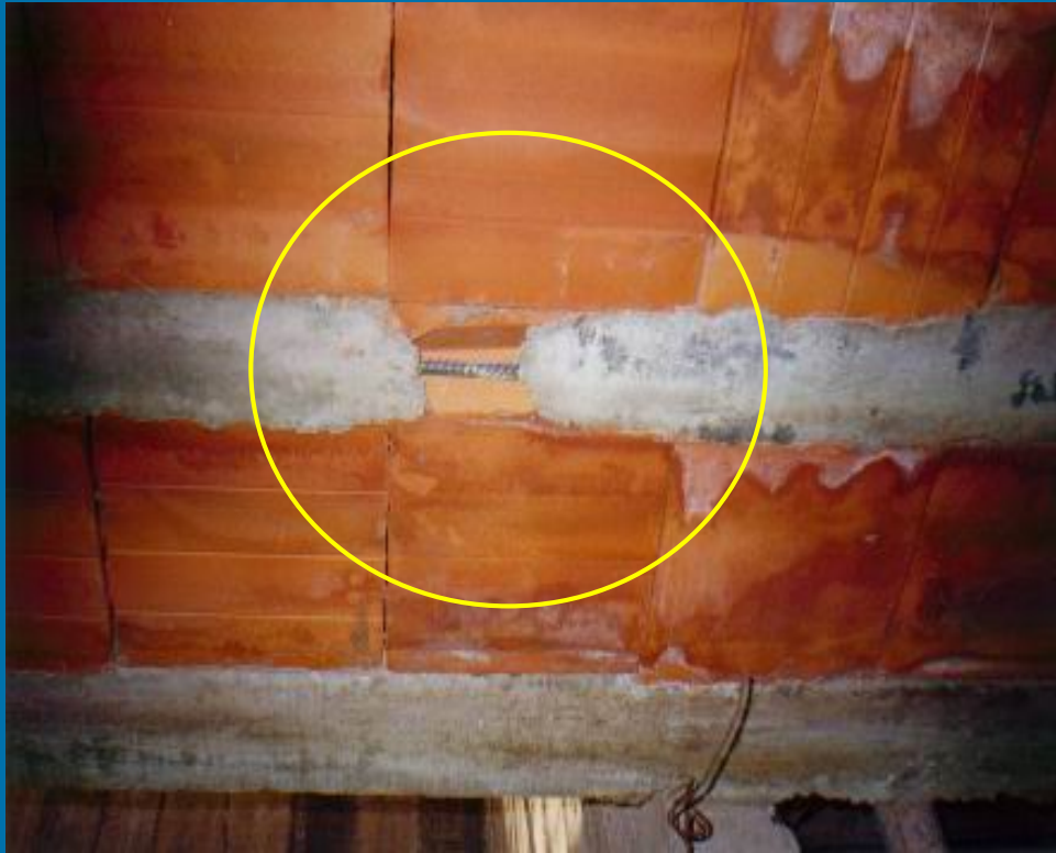
Cangrejera en una vigueta de aligerado
