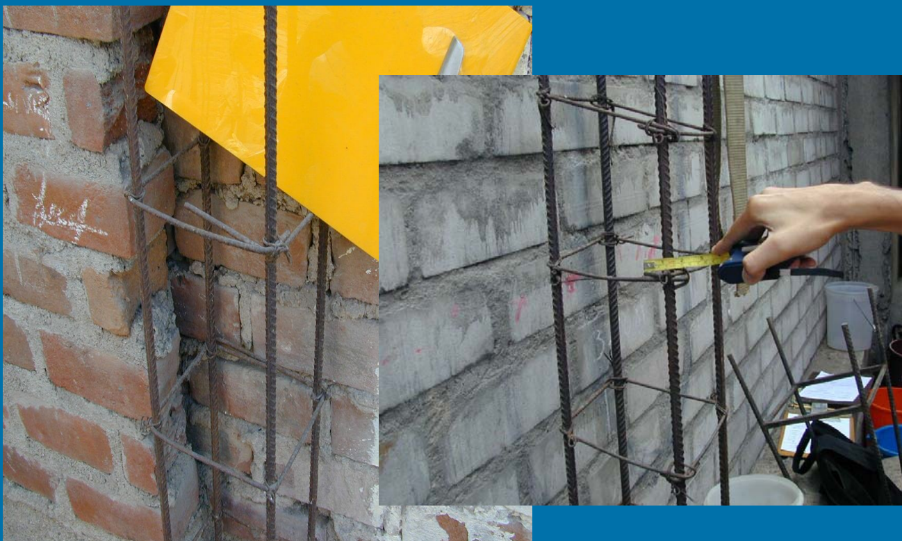
Estribos deficientes. Mala habilitación del fierro
