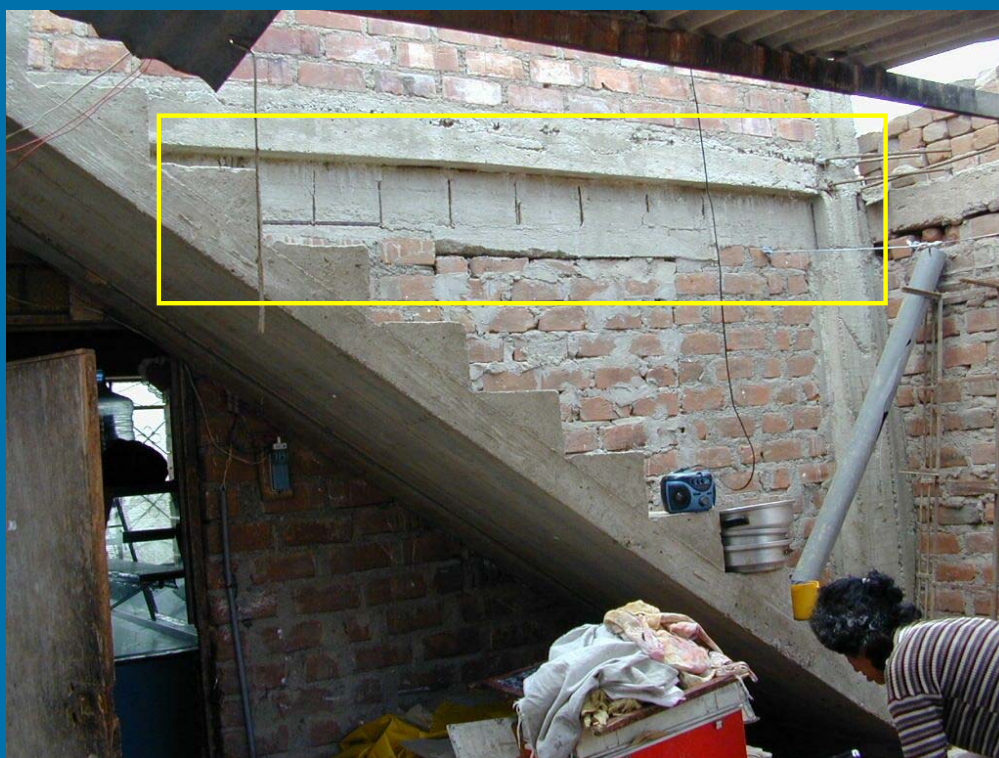
Falta de recubrimientos.
