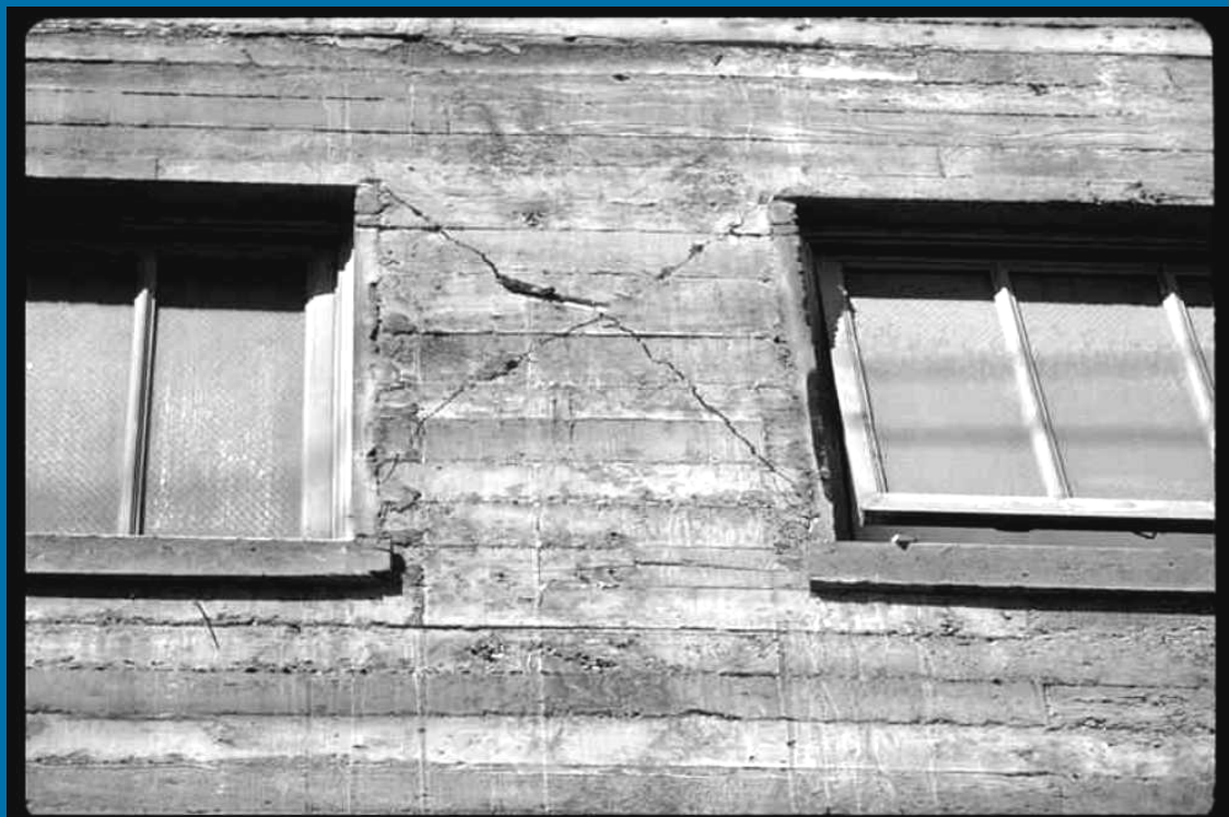
Falla por cortante en columna (placa)
