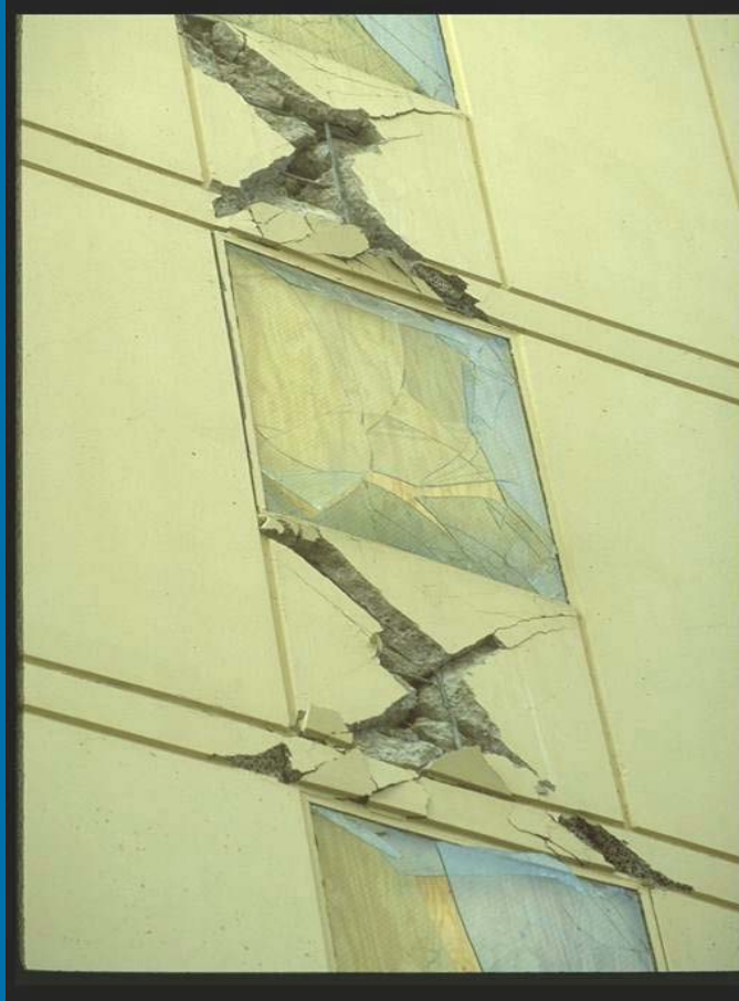
Falla por corte en vigas de acoplamiento
