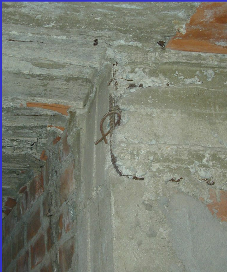
Cangrejas y falta de recubrimiento
