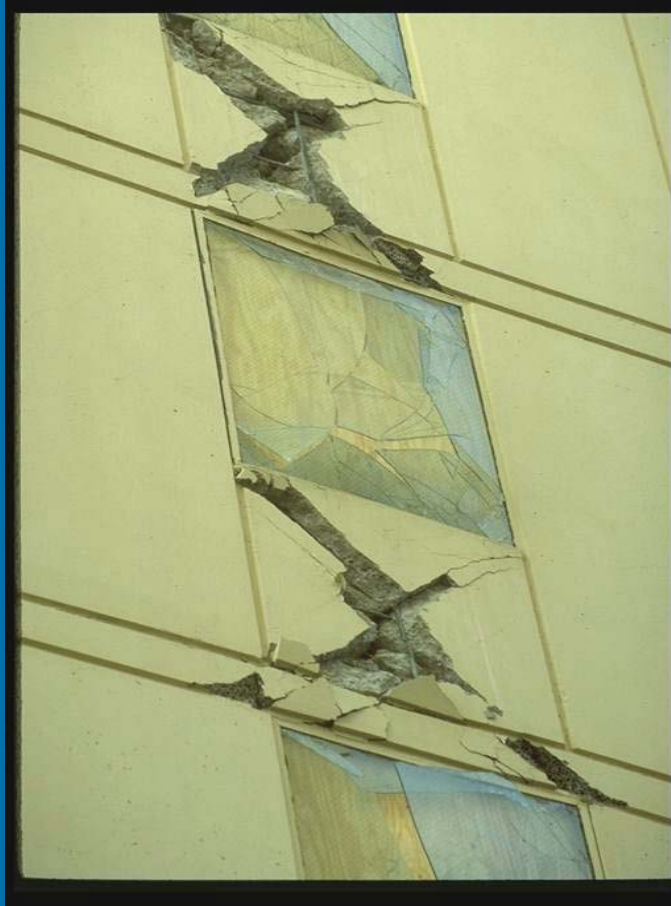
Falla por corte en vigas de acoplamiento
