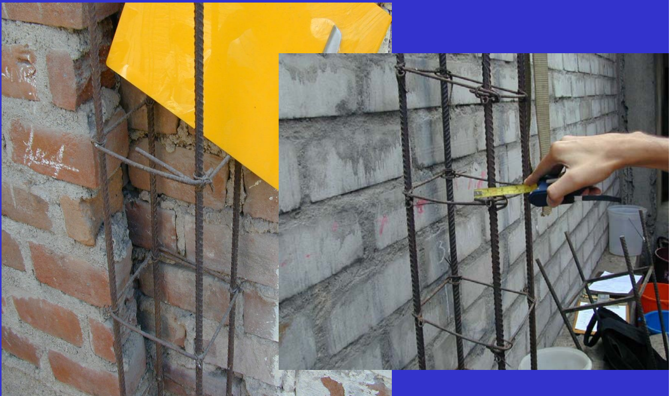
Estribos deficientes. Mala habilitación del fierro
