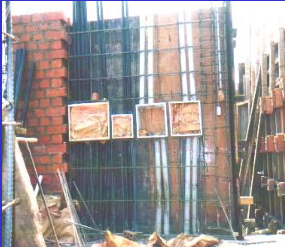
Ductos y cajas para instalaciones eléctricas. Del muro de concreto no quedó nada
