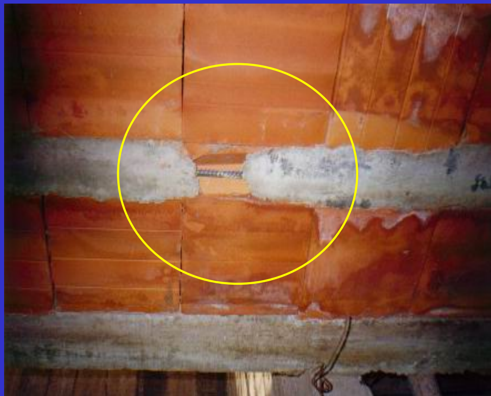
Cangrejera en una vigueta de aligerado
