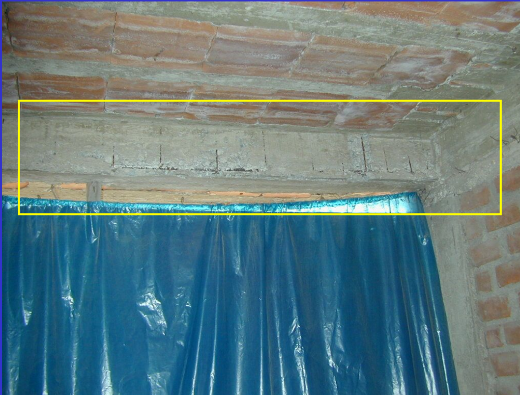
Falta de recubrimiento
