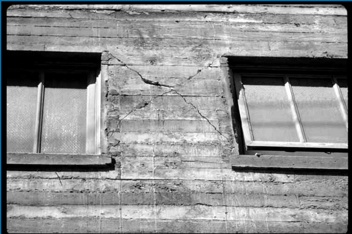
Falla por cortante en columna (placa)
