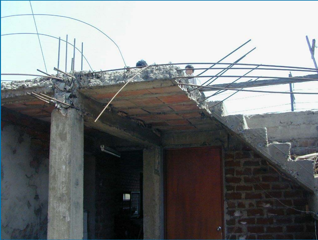
Falta de protección temporal en las armaduras. Futuro problema de corrosión
