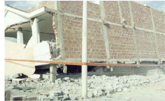
VIVIENDA CON PRIMER PISO COLAPSADO POR FLEXIBILIDAD DE PORTICOS Y AUSENCIA DE MUROS FOTO ANTONIO BLANCO (CIP)
