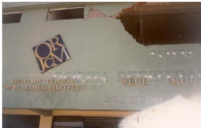
LOCAL DE REGISTROS PUBLICOS CON TABIQUERIA SERIAMENTE AFECTADA FOTO JESUS ABUGATTAS (CIP)
