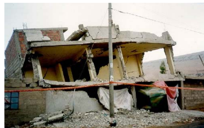
VIVIENDA COLAPSADA POR USO DE PORTICOS FLEXIBLES FOTO FRANKLIN RAMOS (CIP)
