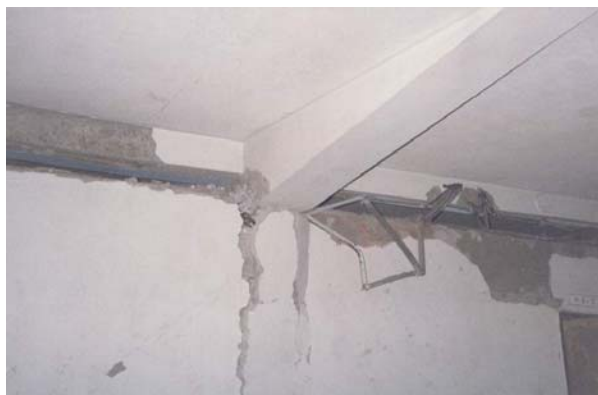
COLAPSO DE COLUMNA POR EFECTO DE COLUMNA CORTA (CHOQUE CON TABIQUERIA) FOTO ANTONIO BLANCO(CIP)
