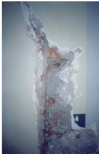
DAÑOS EN LA TABIQUERIA INTERIOR DEL HOSPITAL, OBSERVANDOSE DESPRENDIMIENTOS DE REPARACIONES EJECUTADAS POR DAÑOS DE SISMOS ANTERIORES FOTO ANTONIO BLANCO (CIP)
