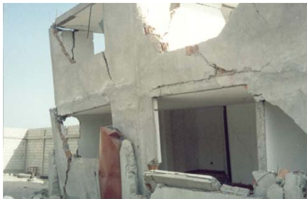
VIVIENDA COLAPSADA FOTO JESUS ABUGATTAS (CIP)
