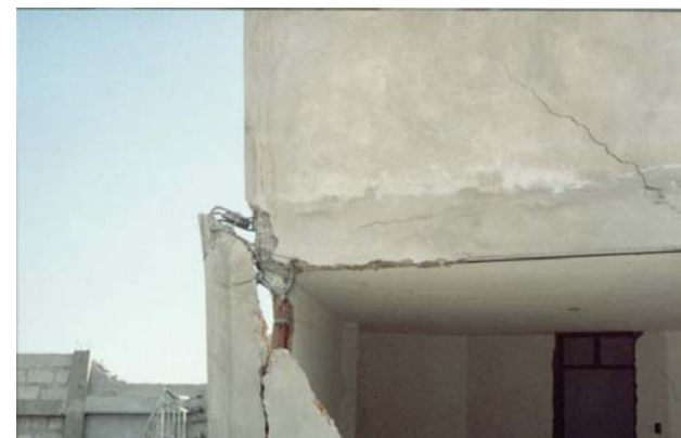
VIVIENDA COLAPSADA FOTO JESUS ABUGATTAS (CIP)
