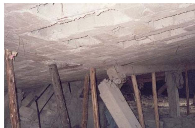
DETALLE DE VIVIENDA COLAPSADA POR GRAVES DEFICIENCIAS DE AUTOCONSTRUCCION (VIGA CHATA, VIGA PERALTADA Y UNION CON COLUMNA) FOTO JOSE LUIS AMADO (CIP)
