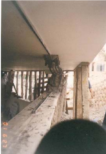
FALLA DE COLUMNA POR EFECTO DE COLUMNA CORTA
