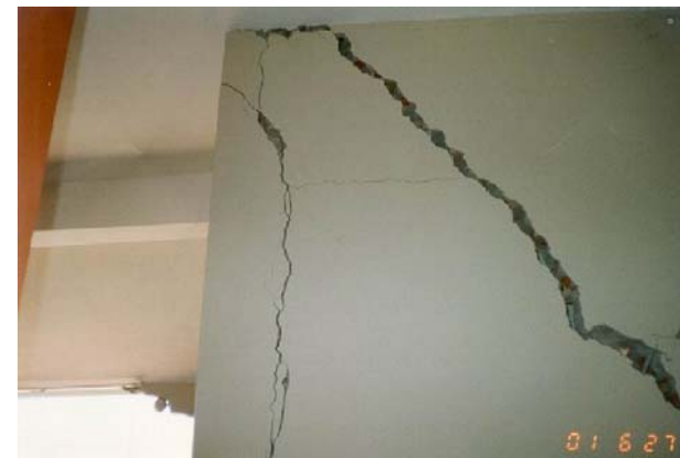
LOCAL DE REGISTROS PUBLICOS CON TABIQUERIA SERIAMENTE AFECTADA FOTO JESUS ABUGATTAS (CIP)
