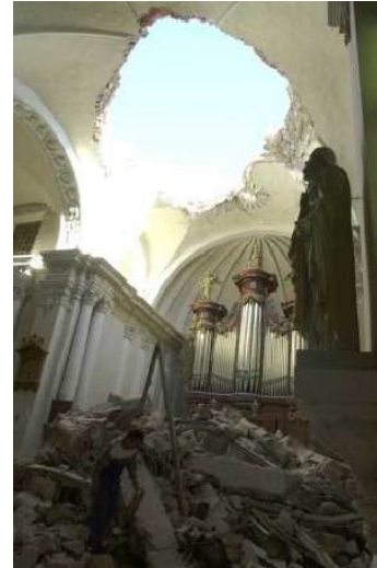
DAÑOS EN ZONA INTERIOR DE LA CATEDRAL
