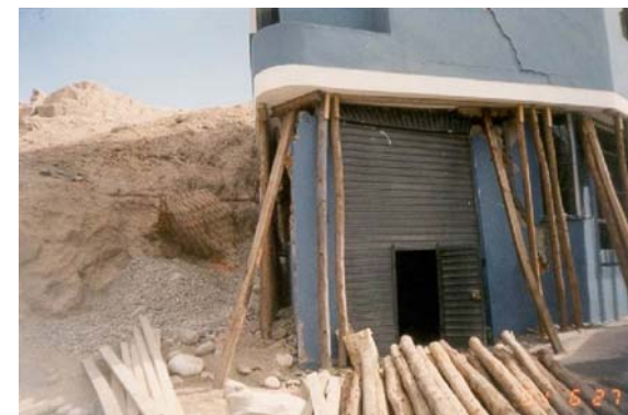
INMUEBLE EN ESQUINA CON PROBLEMAS DE TORSION Y FLEXIBILIDAD FOTO FRANKLIN RAMOS (CIP)
