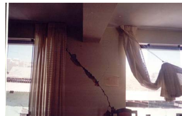
MUNICIPIO DE MOQUEGUA - CENTRO CIVICO. PORTICOS FLEXIBLES Y DAÑOS EN TABIQUERIA FOTO ANTONIO BLANCO(CIP)
