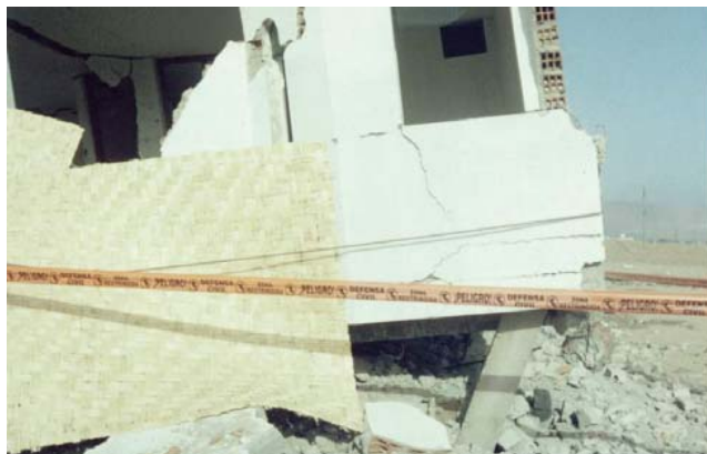
VIVIENDA CON PRIMER PISO COLAPSADO POR FLEXIBILIDAD DE PORTICOS Y AUSENCIA DE MUROS FOTO ALEJANDRO MUÑOZ (CIP)
