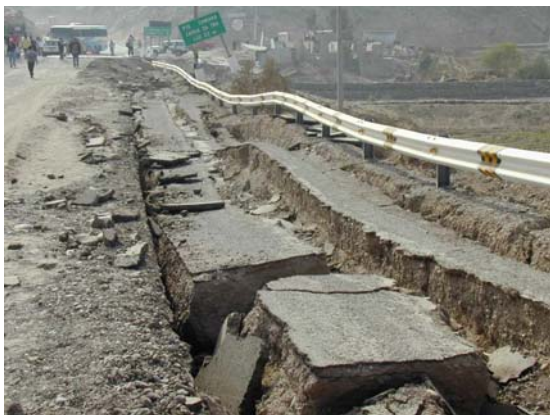
FALLA POR DESLIZAMIENTO Y ASENTAMIENTO EN CARRETERA PANAMERICANA FOTO EDUARDO FIERRO(CIP)
