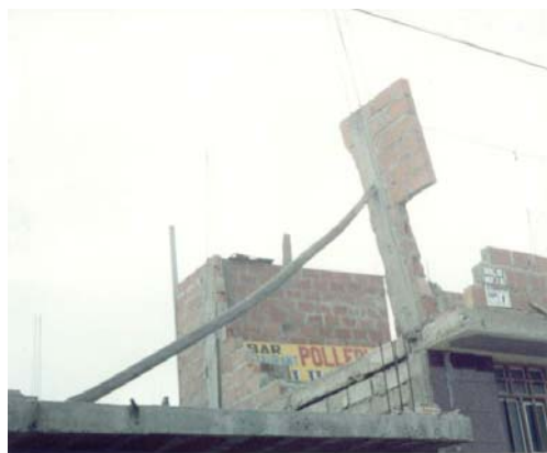
FALLAS EN TABIQUERIA Y COLUMNA EN VOLADIZO FOTO JESUS ABUGATTAS (CIP)
