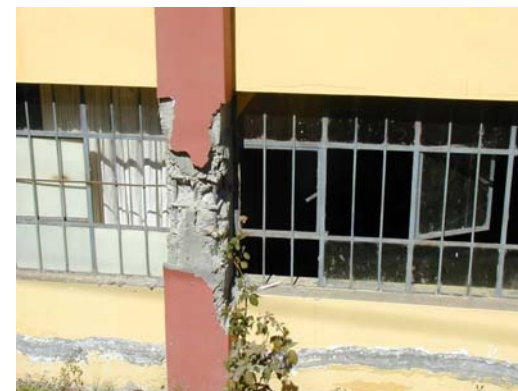
UNIVERSIDAD PRIVADA DE MOQUEGUA CON DAÑOS EN COLUMNAS, TABIQUERIA Y VIGA INTERMEDIA FOTO EDUARDO FIERRO(CIP)
