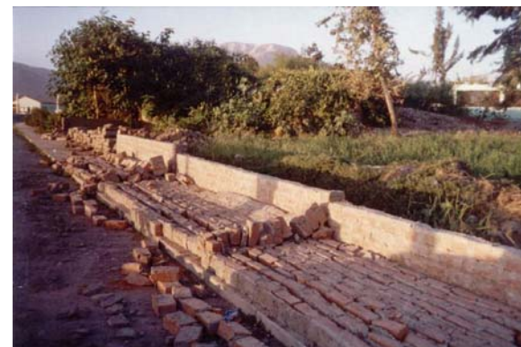
COLAPSO DE MURO DE CERCO POR AUSENCIA TOTAL DE COLUMNAS FOTO ANTONIO BLANCO(CIP)
