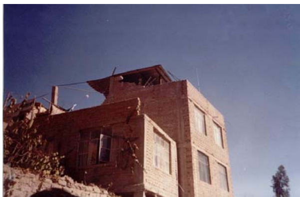
PARAPETOS Y TABIQUERIA DE FACHADA SIN REFUERZOS, CON COLAPSO Y FALLAS PARCIALES FOTO ANTONIO BLANCO(CIP)
