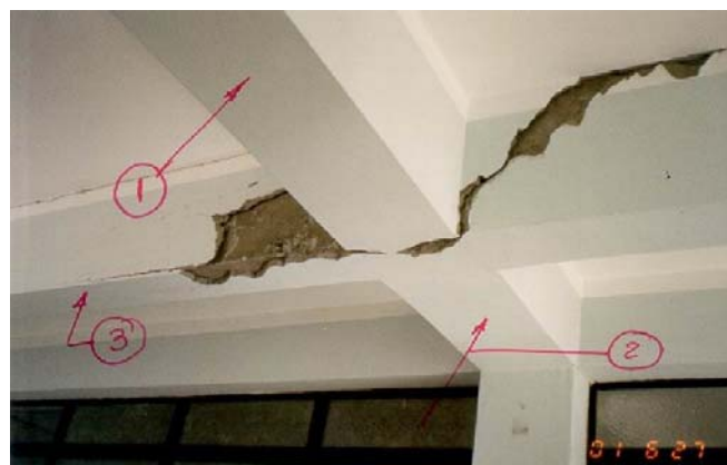
FALLA EN UNION DE VIGAS FUERA DEL PLOMO DE LA COLUMNA EN LOCAL DE REGISTROS PUBLICOS FOTO JESUS ABUGATTAS (CIP)
