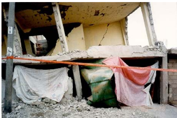
VIVIENDA COLAPSADA POR USO DE PORTICOS FLEXIBLES FOTO FRANKLIN RAMOS (CIP)
