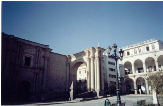
VISTA DEL ARCO UBICADO EN EL FRONTIS DE LA CATEDRAL CON FALLA EN LA ZONA CENTRAL FOTO ANTONIO BLANCO (CIP)
