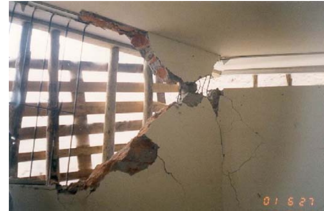
FALLA DE COLUMNA POR EFECTO DE COLUMNA CORTA FOTO FRANKLIN RAMOS (CIP)
