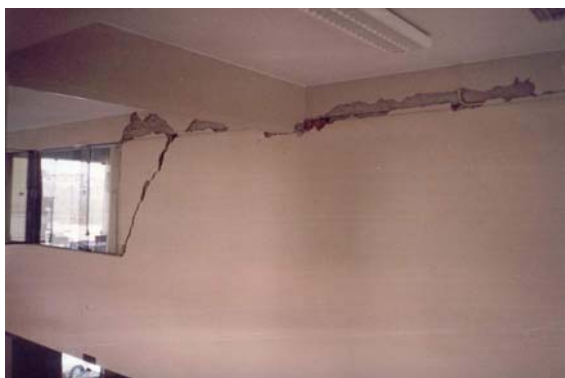
MUNICIPIO DE MOQUEGUA - CENTRO CIVICO. PORTICOS FLEXIBLES Y DAÑOS EN TABIQUERIA FOTO ANTONIO BLANCO(CIP)
