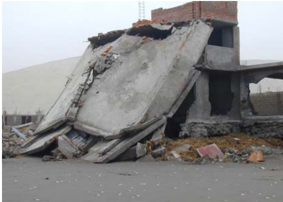
RESTOS DE VIVIENDAS AFECTADAS POR EL INGRESO DEL AGUA DEL MAR Y EL SISMO FOTO EDUARDO FIERRO (CIP)
