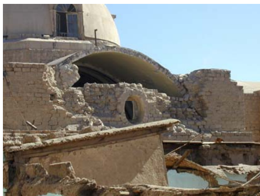
DAÑOS EN CATEDRAL DE MOQUEGUA FOTO EDUARDO FIERRO (CIP)
