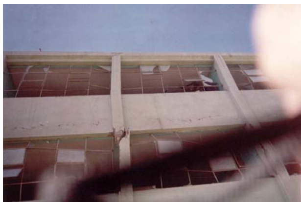
COLEGIO CON FALLAS EN COLUMNAS POR FLEXIBILIDAD DE PORTICOS Y CHOQUE CON TABIQUERIA FOTO ANTONIO BLANCO(CIP)
