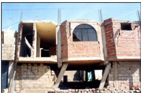
Foto 17. Falla por mecanismo de piso blando en una vivienda en Tacna.
