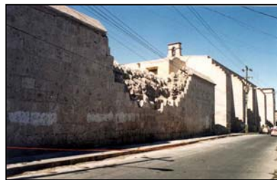
Foto 22. Daños en el muro perimetral en la Iglesia de Santa Teresa, Arequipa.
