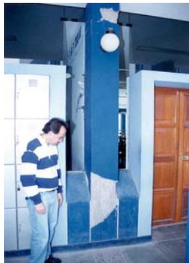
Foto 6. Los tabiques aislados y mal arriostrados quedaron inestables, CE Santa Fortunata El Cerrillo.
