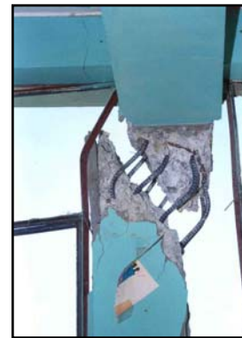
Foto 4. Falla de cortante en columna C.E. Angela Barrios, Moquegua.
