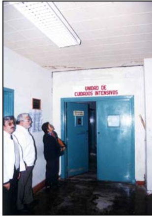
Foto 11. Averías en las redes de agua del Hospital Hipólito Unanue, Tacna.
