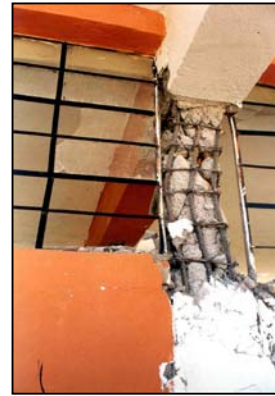
Foto 2. Falla de columna corta en un pabellón del CE Casimiro Cuadros
