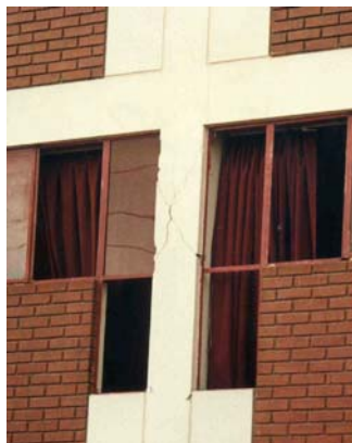
Foto 7. Problema de columna corta por interacción con el marco de la ventana. Universidad San Agustín, Arequipa.
