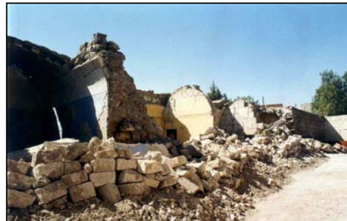
Foto 14. Vivienda de sillar colapsada en Arequipa.
