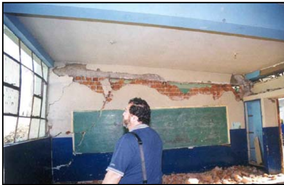
Foto 3. Falla de columna corta con pérdida de altura, C.E. Angela Barrios, Moquegua.
