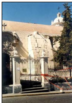
Foto 21. Iglesia Santa Marta, Arequipa, con contrafuertes agrietados al controlar el movimiento del cuerpo central.
