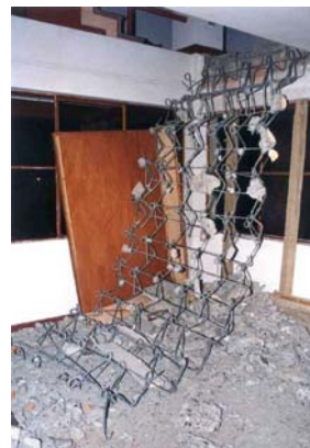
Foto 8. Colapso de escalera tipo alfombra al ser solicitada axialmente, Universidad San Agustín, Arequipa.
