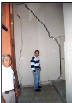
Foto 23. Daños en el Edificio de Registros Públicos de Moquegua.
