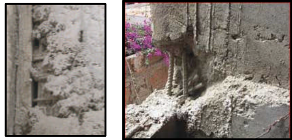
Fig.3. Cangrejas en muros delgados.
