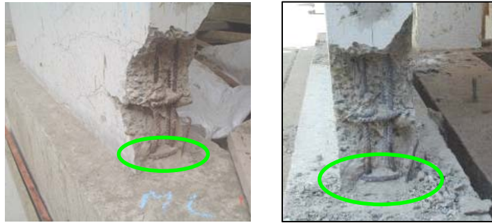
Fig.7 Corrimiento del primer estribo en el talón derecho de MC. Inspección después del ensayo.
