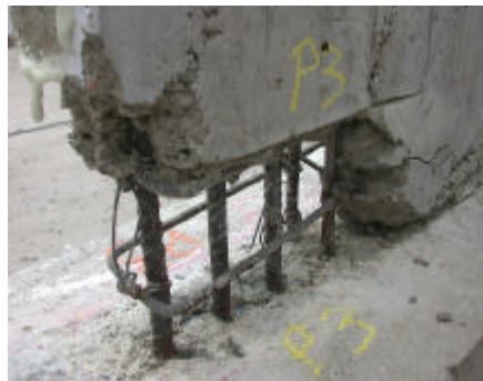
Foto 14. Placa P3. Inspección post-ensayo. Pequeño pandeo de las barras extremas (izq.) y comportamiento adecuado de las espigas de acero convencional (der.).
