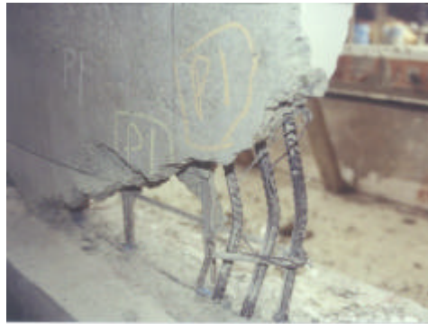
Foto 12. Placa P1. Inspección post-ensayo. Pandeo del refuerzo vertical extremo y rotura de la franja de malla electrosoldada embutida en la cimentación.
