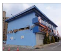
Colapso del 1 er piso
